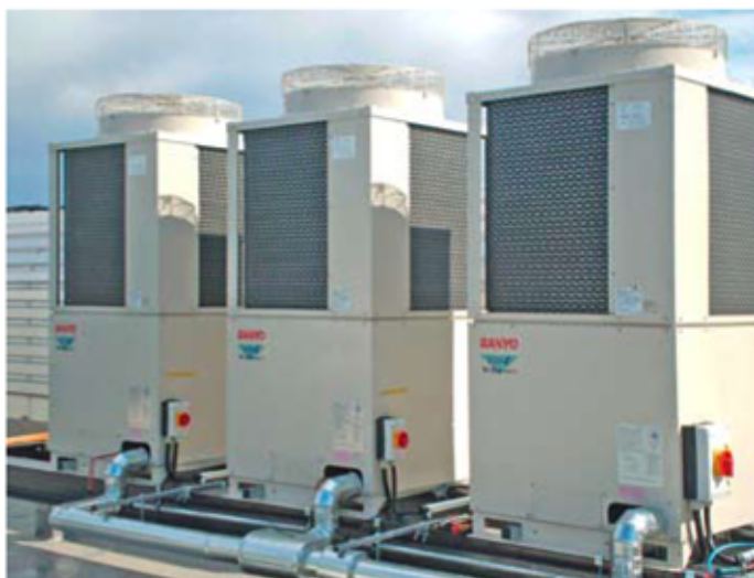
Die drei Außengeräte stehen platzsparend und dezentral auf dem Dach des Heizkraftwerks.
