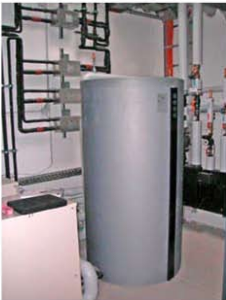
Pufferspeicher für das Wärmerückgewinnungssystem.
