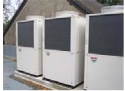
Installierte Gas- Wärmepumpe mit 3 Außengeräten, Fabrikat Sanyo, Gesamtleistung 78 kW im Kühlbetrieb und 84 kW im Heizbetrieb
