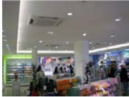
Innenbereich des Drogeriemarktes Douglas, klimatisierte Fläche 250 m 2 durch 4-seitig ausblasende Deckenkassetten, Fabrikat KautiSanyo
