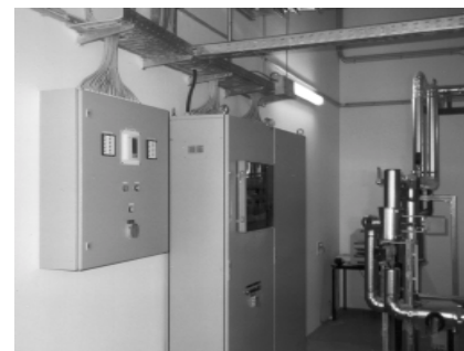
Links neben dem Schaltschrank: Systemfernbedienung und Überwachung der drei Anlagen im 4. Obergeschoß.
