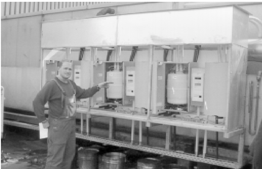
3 Dampfluftbefeuchter der Nordmann-Serie AT 3000-9064 bringen zusammen eine Leistung von 270 kg/h.
