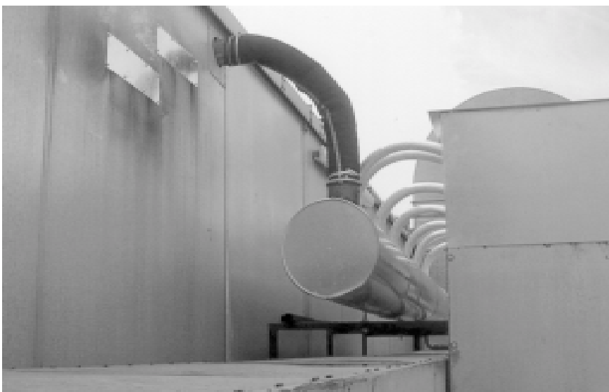
Die 12 Dampfaustritte werden auf einen gemeinsamen Dampfsammler mit Dampf- und Kondensatablauf geführt.
