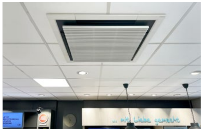
In einer Tankstelle
