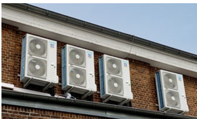
PAC Außeneinheiten von Hisense – Für kurze Leitungswege wurden die Außengeräte oberhalb eines Vorsprungs an der Fassade des Gebäudes installiert.
