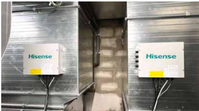
Die von außen an den Lüftungsanlagen angebrachten Steuereinheiten für externe Wärmeübertrager
