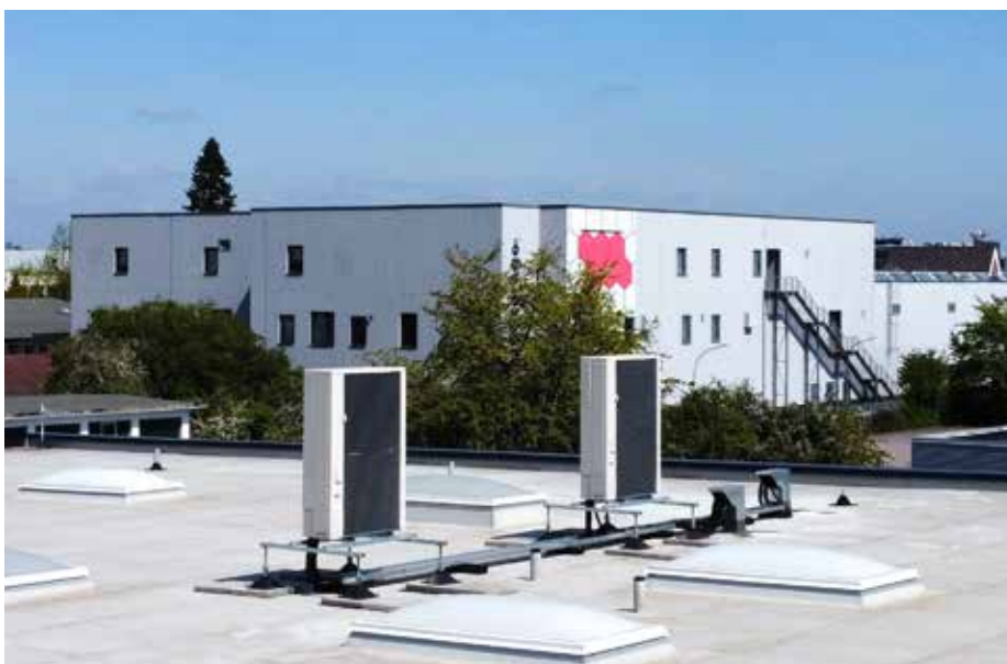
Aufstellung der Außeneinheiten auf dem Flachdach
