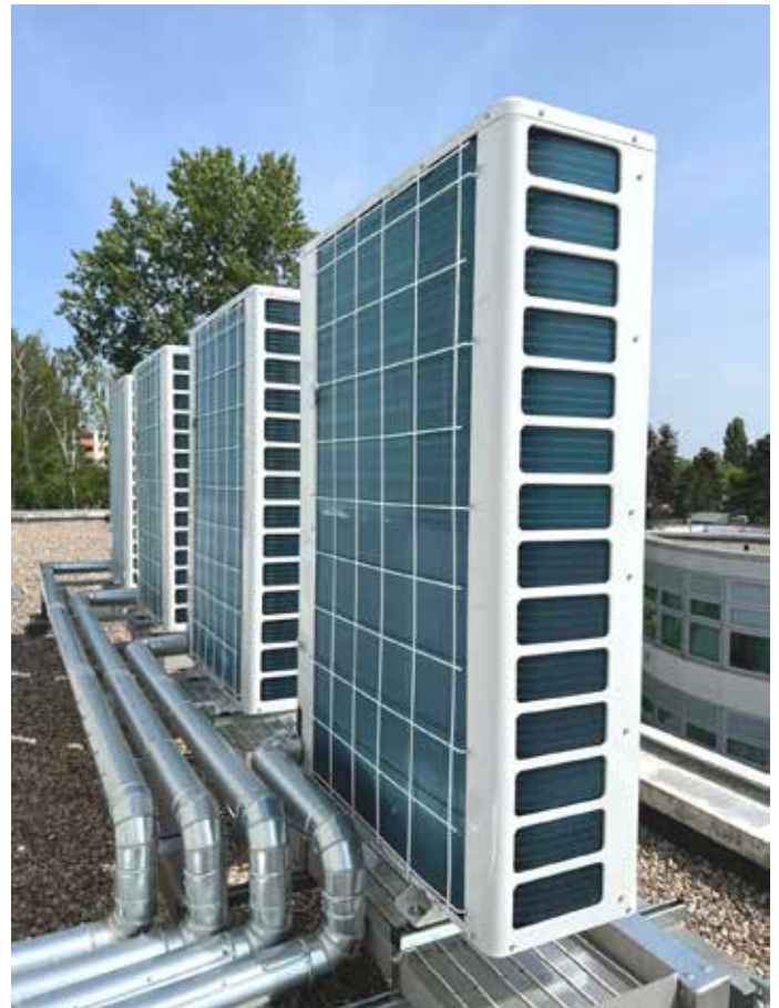
Die mit Ölauffang- und Abscheidesystemen ausgestatteten Außeneinheiten
